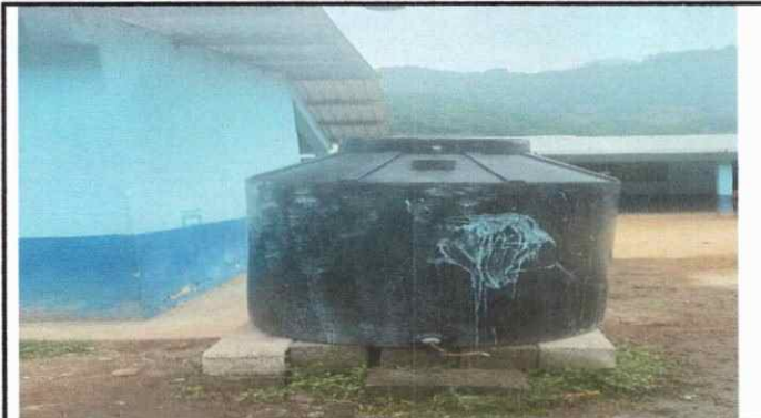
Foto 3: Se requiere sustitución de tinaco.
