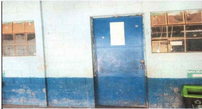
Foto 1: Se observa que la puerta esta oxidada y en mal estado, modulo 1 y 2.
