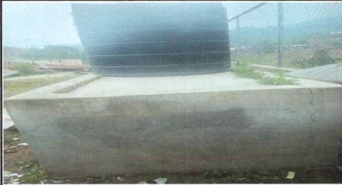
Foto1: Se requiere sustitución de tinaco.
