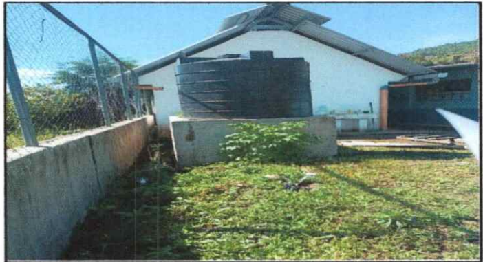
Foto 4: Se observa los depositos de agua en mal estado y con el lugar inadecuado, se requiere sustitución. Modulo cocina
