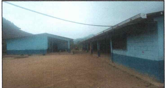
Foto 4: Se requiere pintura en muros exteriores e interiores. Modulo 1 y 2
