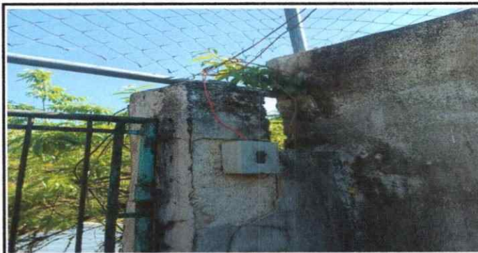
Foto 5: Se requiere sustitución de tablero de flipones.
