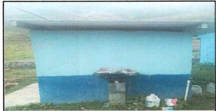
Foto 6: Se requiere sustitución de lavamanos.
