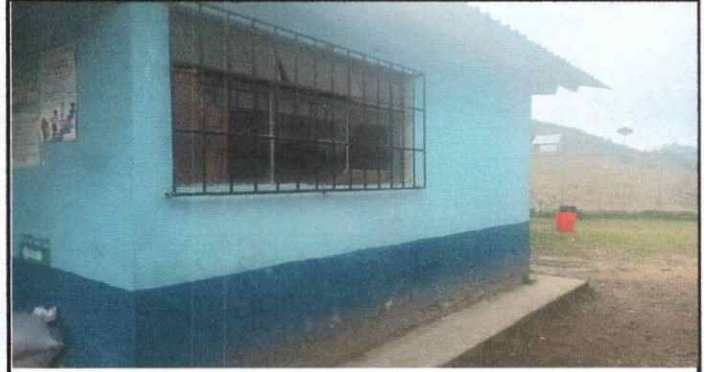
Foto 2: Se requiere reparación de balcones de ventanas, modulo 1
