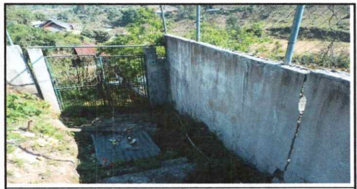
Foto 6: Se requiere reparación, muro de circulacion.
