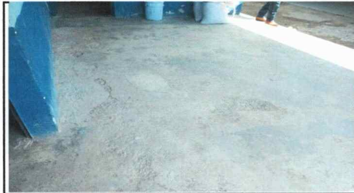
Foto 3: Se requiere sustitución a piso granito, modulo 2 y Dirección
