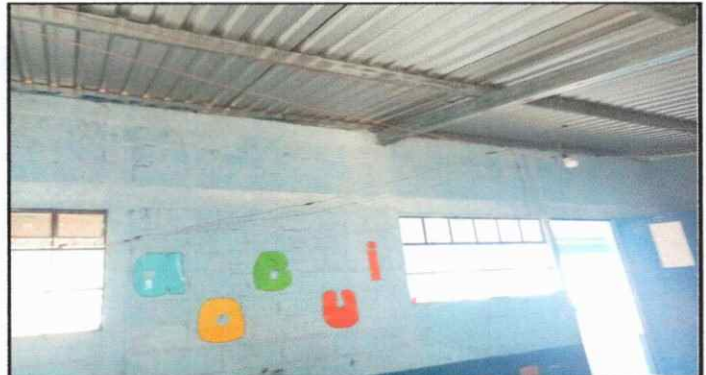
Foto 4: Se observa cableado de la energía eléctrica con numeros de cables no recomendadas y con malas conexiones, modulo 1 y 2
