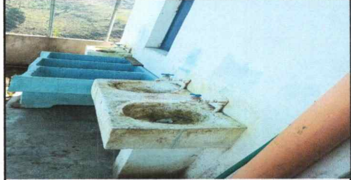
Foto 6: Se requiere sustitución de pila. Modulo cocina
